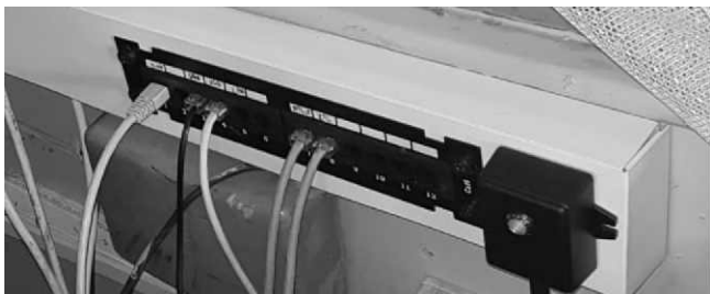
Patchpanel - ND Kielcza "Kla", IZ Opole - fot. PKP TELKOL
