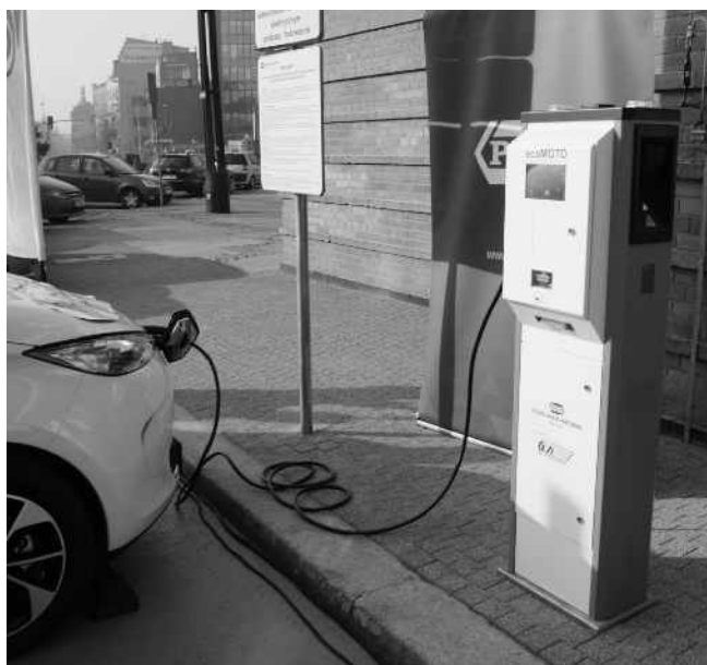
Stacja ładowania pojazdów elektrycznych przy dworcu PKP w Gliwicach. Fot. PKP TELKOL
